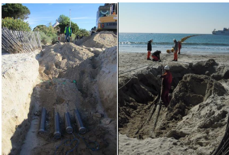
Figure 7 : Illustration de l'installation de conduites d'accueil en haut de plage (à gauche), puis de conduites dégagées à l'occasion de la réception d'un câble (à droite )
