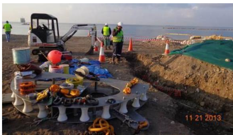
Figure 17 : Vue d'un quadrant (source : Orange Marine)
