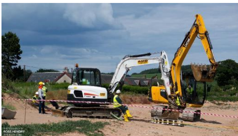
Figure 16 : Opération de tirage de câble avec deux pelleteuses et un quadrant (source : Orange Marine)
