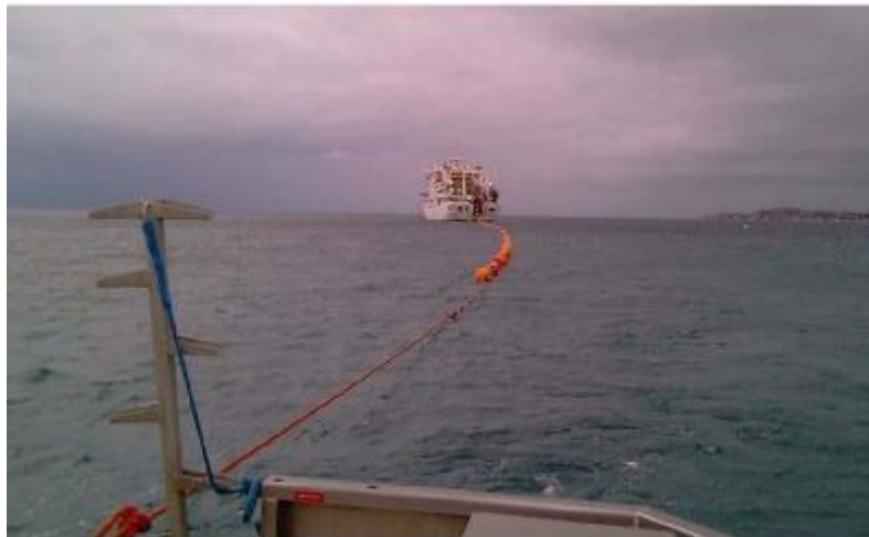
Figure 15 : Exemple de tirage d'un câble depuis un navire câblé vers la plage (source : Orange Marine)
